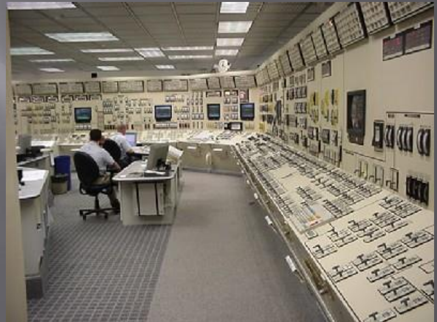
Sala de controle.
